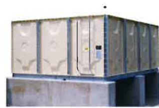
パネルタンク
